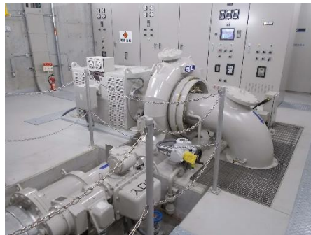
山佐発電所内部
