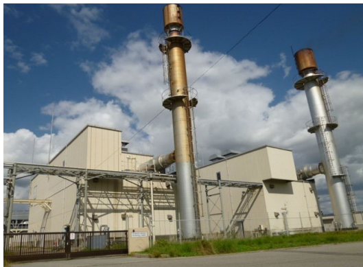
佐和田発電所株式会社：外観
