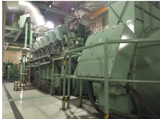
佐和田発電所株式会社：発電用エンジン
